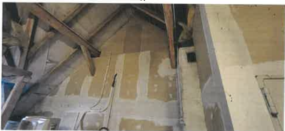
Fot.7. Ścianka oddzielenia przeciwpożarowego przez którą przechodzą elementy konstrukcyjne oraz przepusty instalacyjne.
