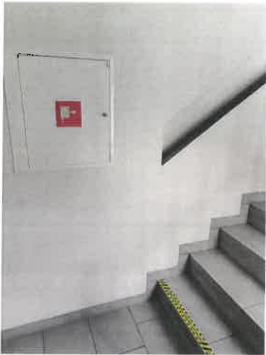
Fot.17. lokalizacja szafek hydrantowych w klatce schodowej
