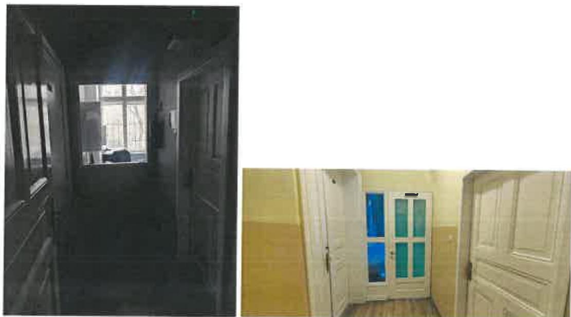
Fot.12 i 13. Otwory bezklasowe na poziomej drodze ewakuacyjnej
